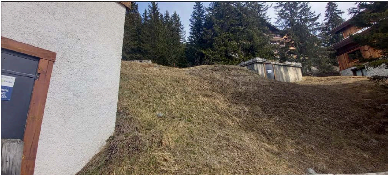
Orée du Bois : Réservoir récent à gauche et double cuve à renouveler à droite
